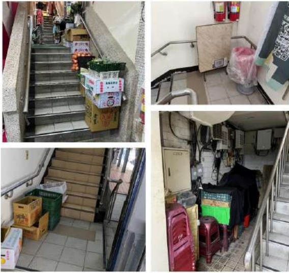
圖 2 樓梯阻擋，影響疏散效率
